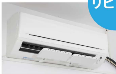
家庭用エアコン設置例
