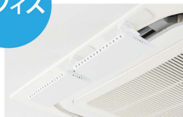
業務用エアコン設置例
