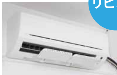
家庭用エアコン設置例
