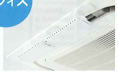
業務用エアコン設置例
